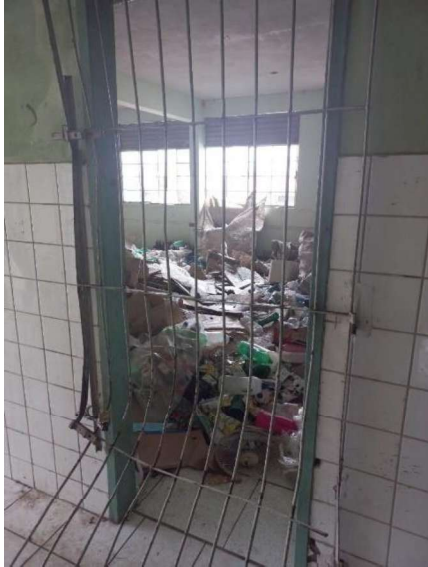
FOTO 25 – Sala de aula com portão de ferro
