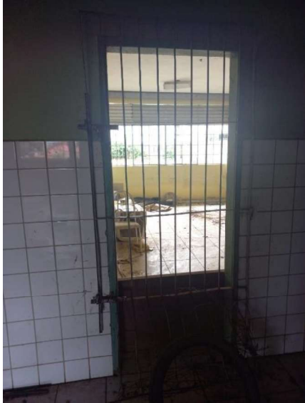
FOTO 23 – Sala de Aula com portão de ferro
