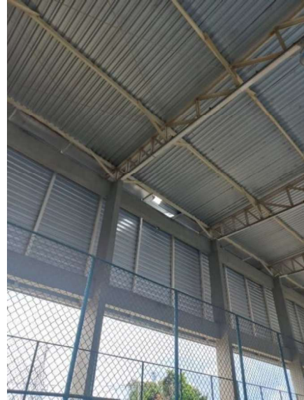
FOTO 48 – Calha necessitando de reparos
