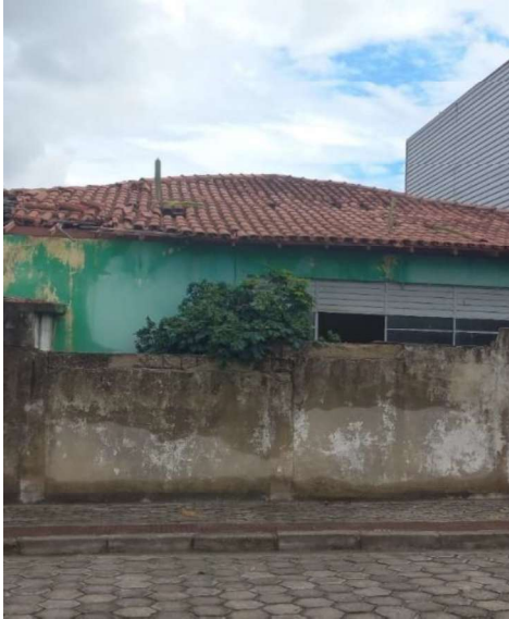
FOTO 09 – Muro e telhado com anomalias
