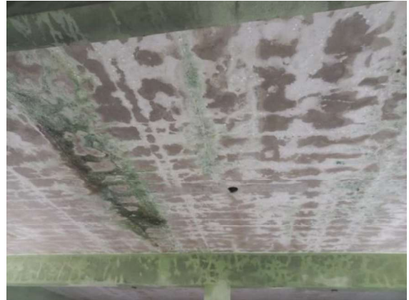
FOTO 14 – Infiltrações no teto da Circulação
