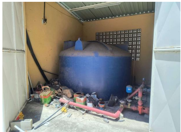
FOTO 43 - Reservatório de Incêndio
