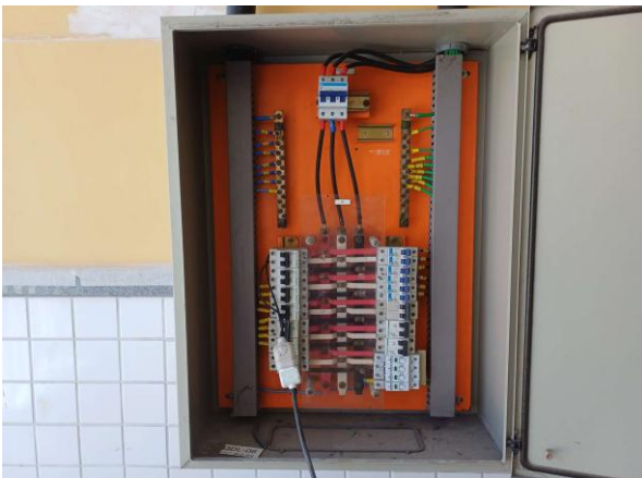
FOTO 42 - Quadro Geral de Baixa Tensão
