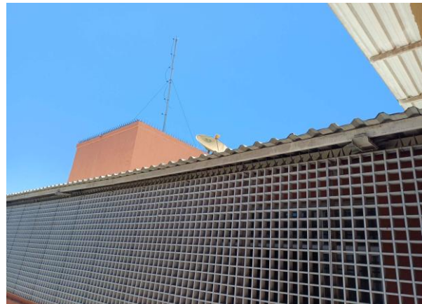
FOTO 45 - Vista parcial do sistema SPDA
