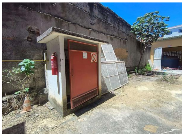
FOTO 44 - Central de Gás
